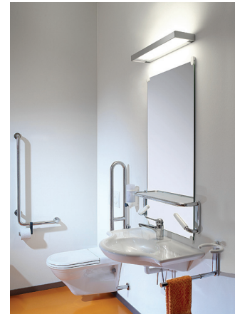
Die direkt-indirekte Badbeleuchtung sorgt für mehr Sicherheit und lässt das Bad größer wirken.
